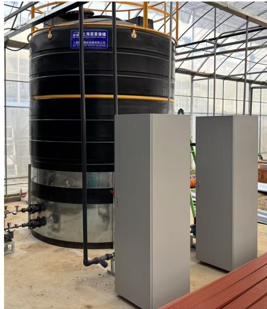
项目现场 | 处理设备与储罐
